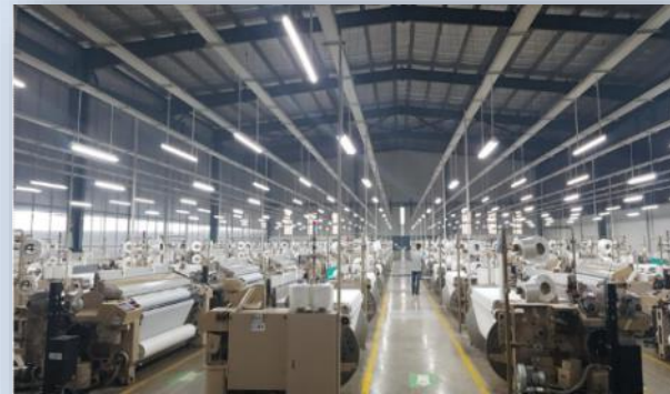
방글라데시 공장 내 설치된 LED
